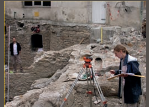
Relevé des altitudes avec un niveau de chantier Reading of altitudes using a site level
