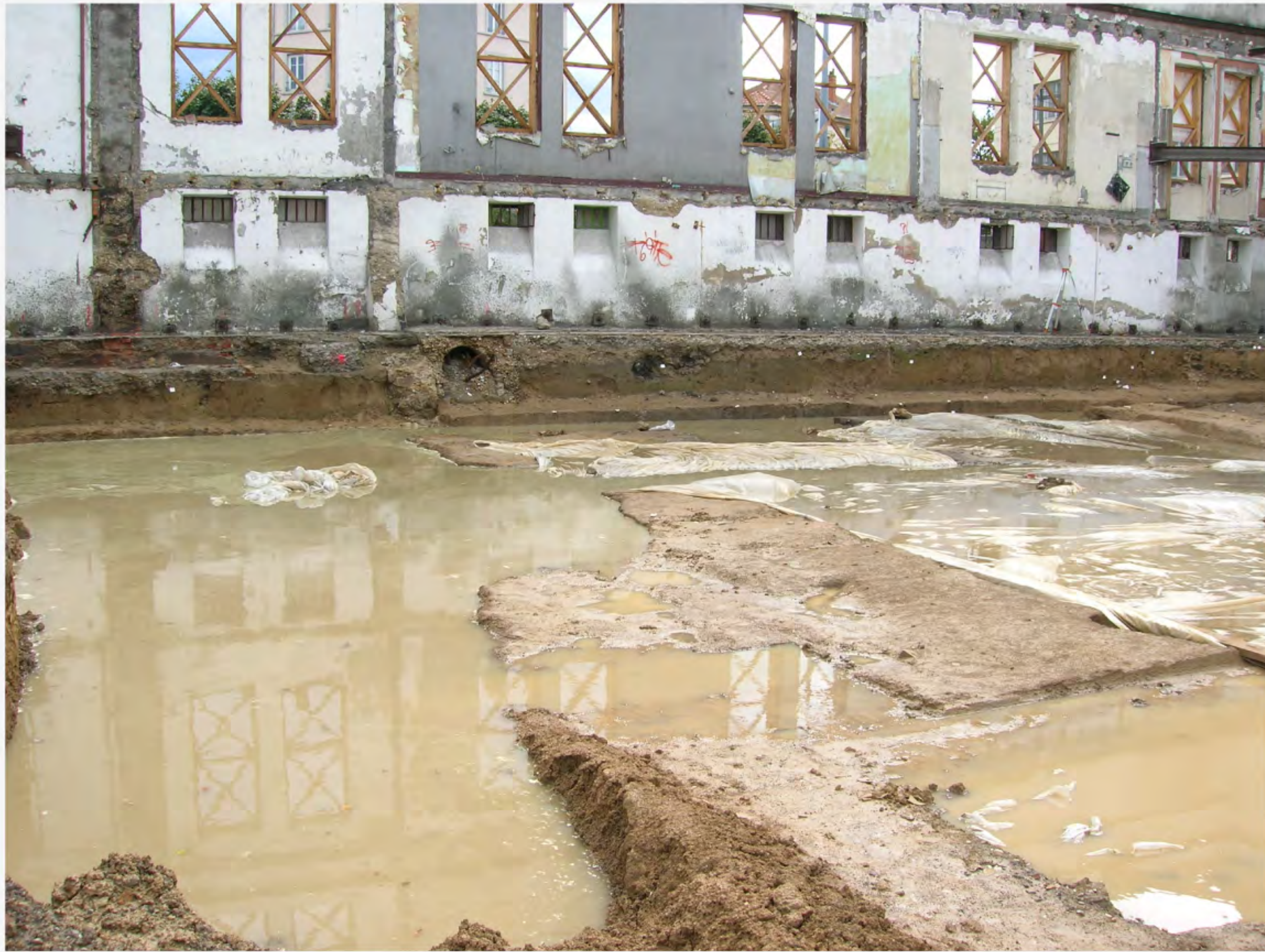
vue générale de la fouille inondée par de violentes pluies
