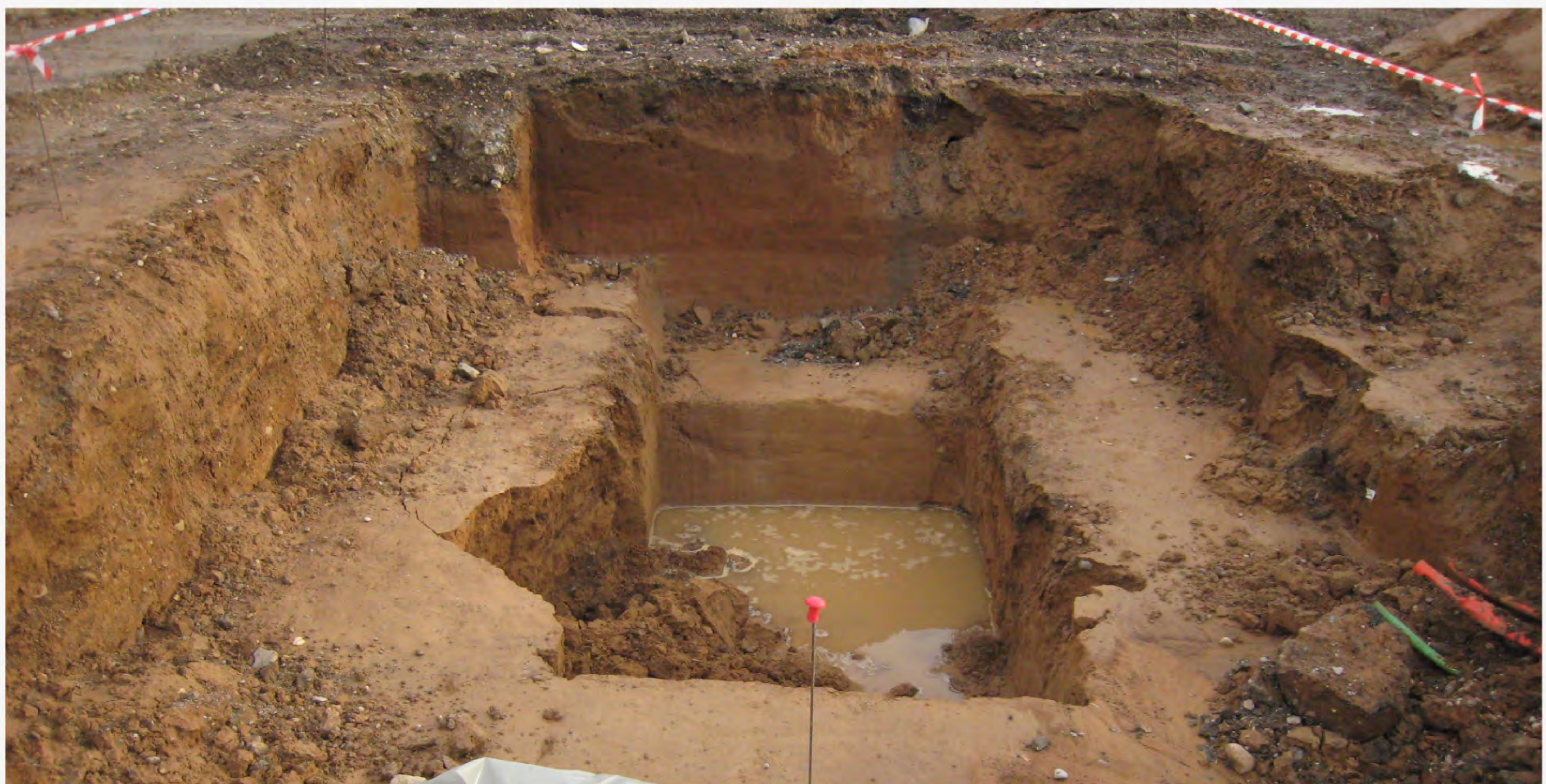
vue d'un sondage aux parois éboulées après des précipitations
